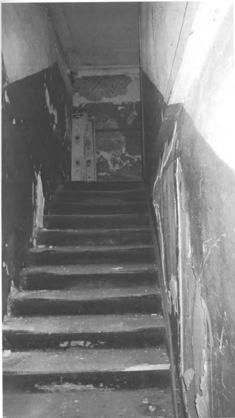
18. Сестрорецк, Дубковское шоссе, 1. 1 этаж. Лестница в юго-западной части здания. Фото: М. И. Мильчик. 12.06.2013.
