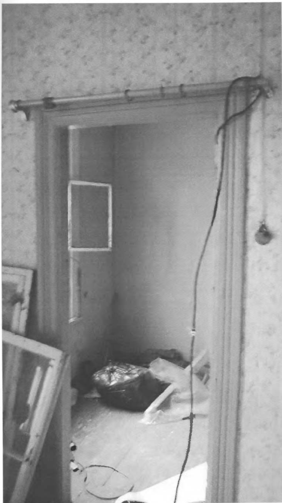
33. Сестрорецк, Дубковское шоссе, 1. 2 этаж. Дверной проём между двумя помещениями восточной части здания. Фото: М. И. Мильчик. 12.06.2013.
