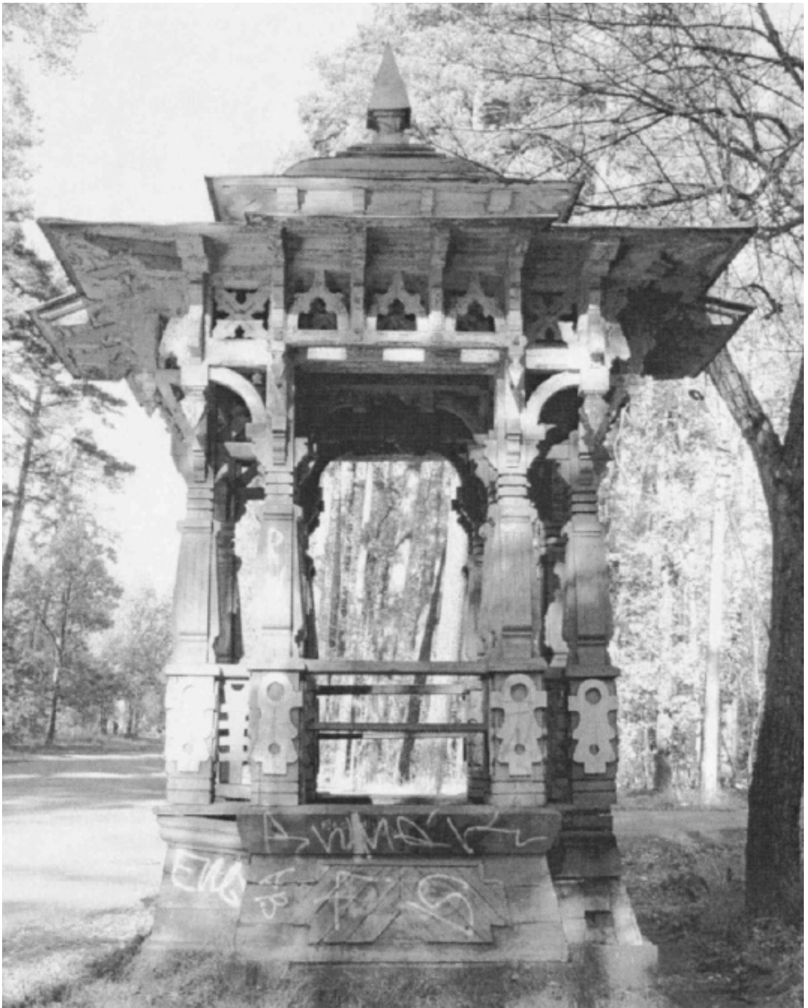
13. Беседка. Фасад 3. Технический отчет по результатам фотограмметрической съемки фасадов здания, расположенного по адресу: ст. Курорт, ул. Андреева, Беседка Шаляпина. ООО «Геотек». СПб. 2004 г. // Архив КГИОП СПб.
